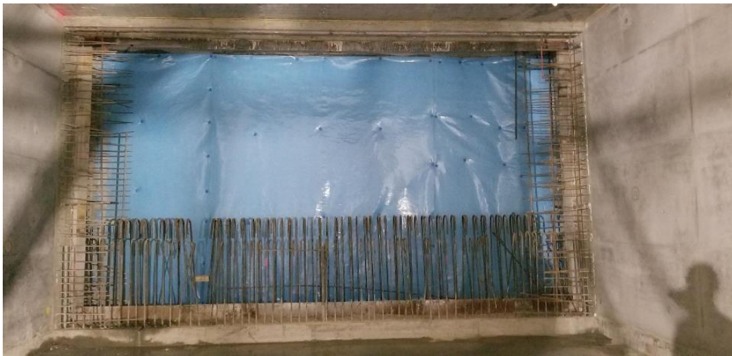
Abbildung 2.5.3: Wandöffnung zur Herstellung der Prototypenwand in der Ebene –5 des Notausstiegs Quellenstraße beim Bauvorhaben U2 der Wiener Linien
